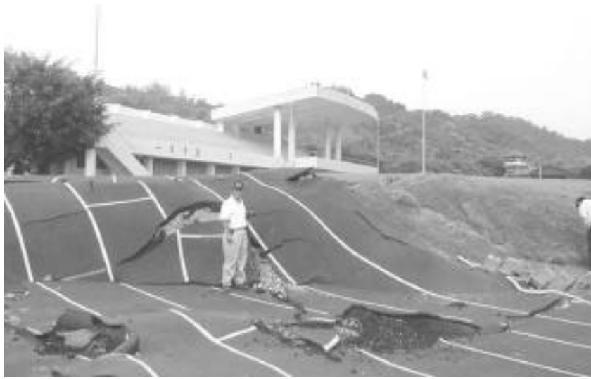
道路崩塌情形下
